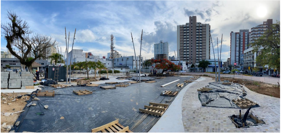
FIGURA 23 – Imagem de um canteiro de obras
